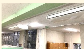
↑昇降口にも 2基のエアコン
